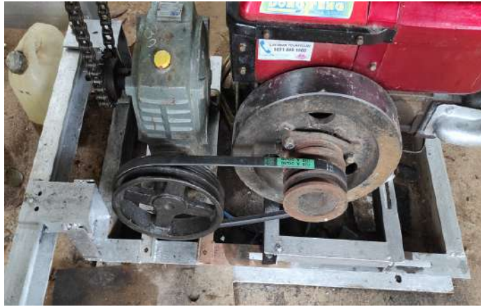
Instalasi Puli Sistem Penggerak
