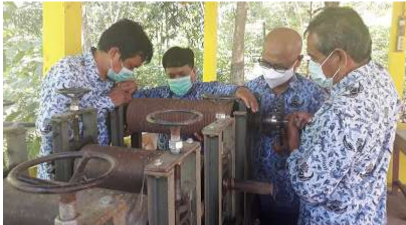
Instalasi Rooling Penggiling Penggerak
